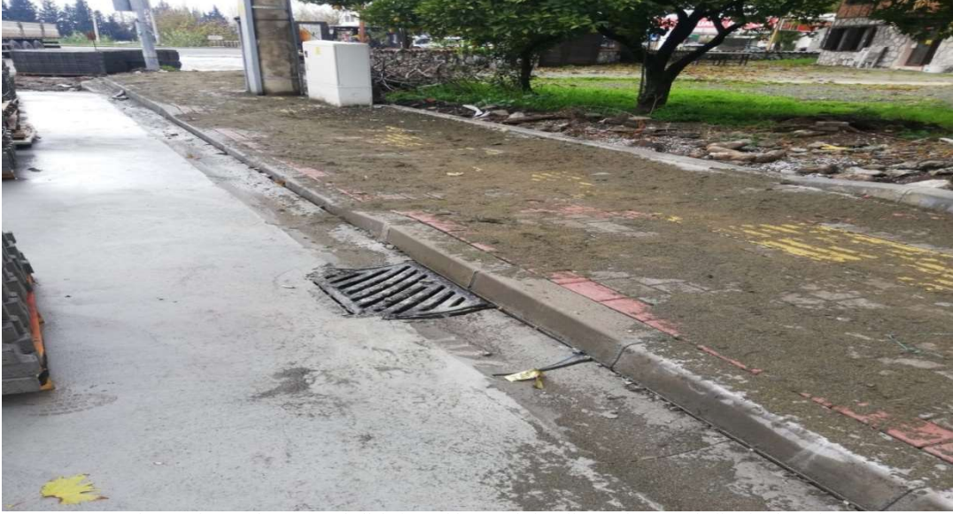
Görsel-23 Parke taşı döşenen Mahallelerin Cadde ve Sokak yollarının kenarına kullanılan hazır beton
